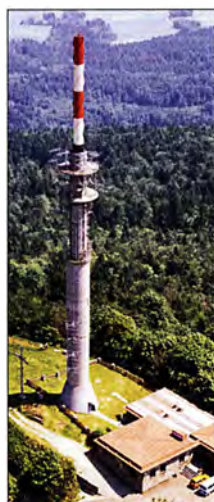
Nachdem im Jahr 1976 die Antennenanlage wieder komplett aufgebaut war, kehrte für einige Jahre Ruhe auf der Station ein. Erst 1990 wurde das Stationsgebäude wieder erweitert.
