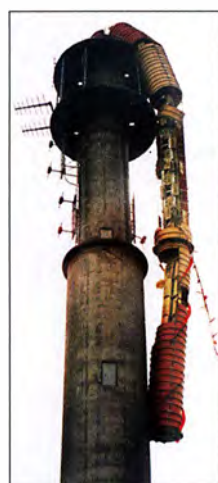
Am Kirchweih-Sonntag, dem 20. Oktober 1974, knickte eine schwere Sturmböe den Antennenträger wie ein Streichholz ab.
