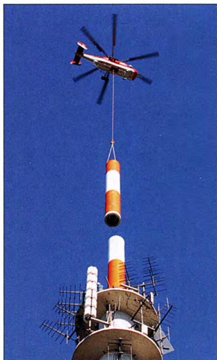
Im Zuge der DVB-T-Einführung im Spätherbst 2006 bekam der Stahlbetonturm eine neue Spitze mit UHF- und VHF-Antennen.
