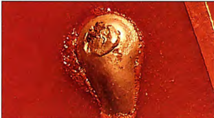
Bild 6: Die Oberflächenbeschaffenheit dieser Lötstelle lässt auf tieferliegende Probleme schließen.
